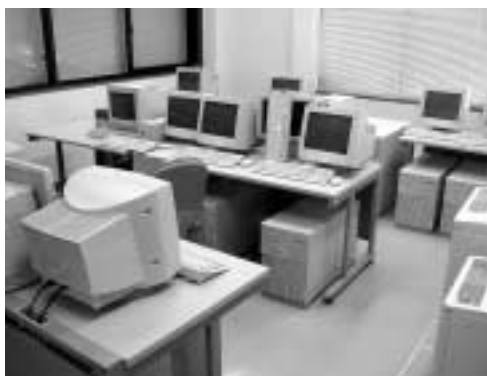
サーバールーム
